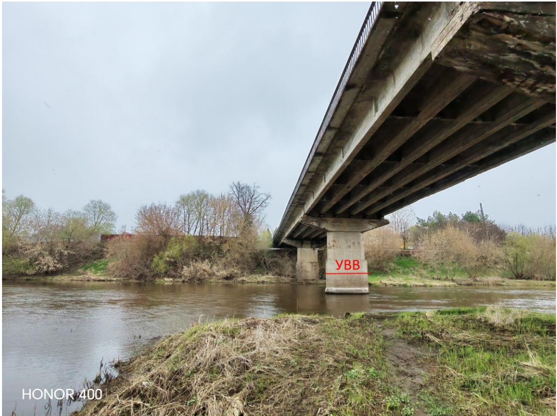
Рисунок П.3 – Уровень высокой воды по следам на опоре моста
