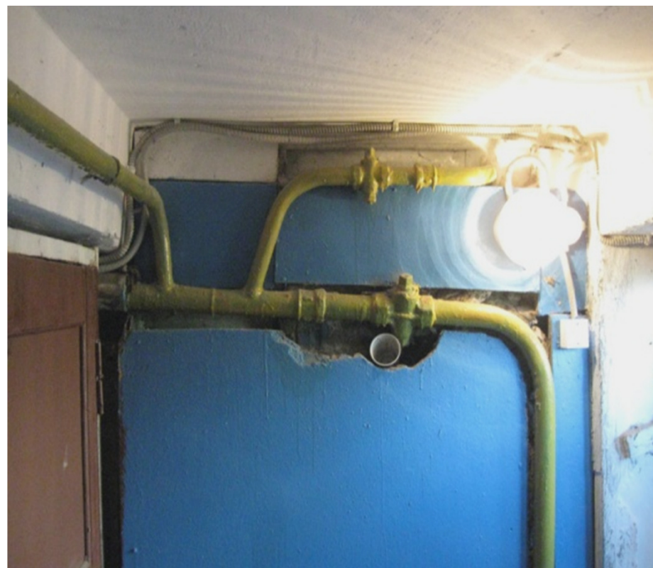
✓нарушение правил монтажа газопроводов, близость прокладки электрической проводки
