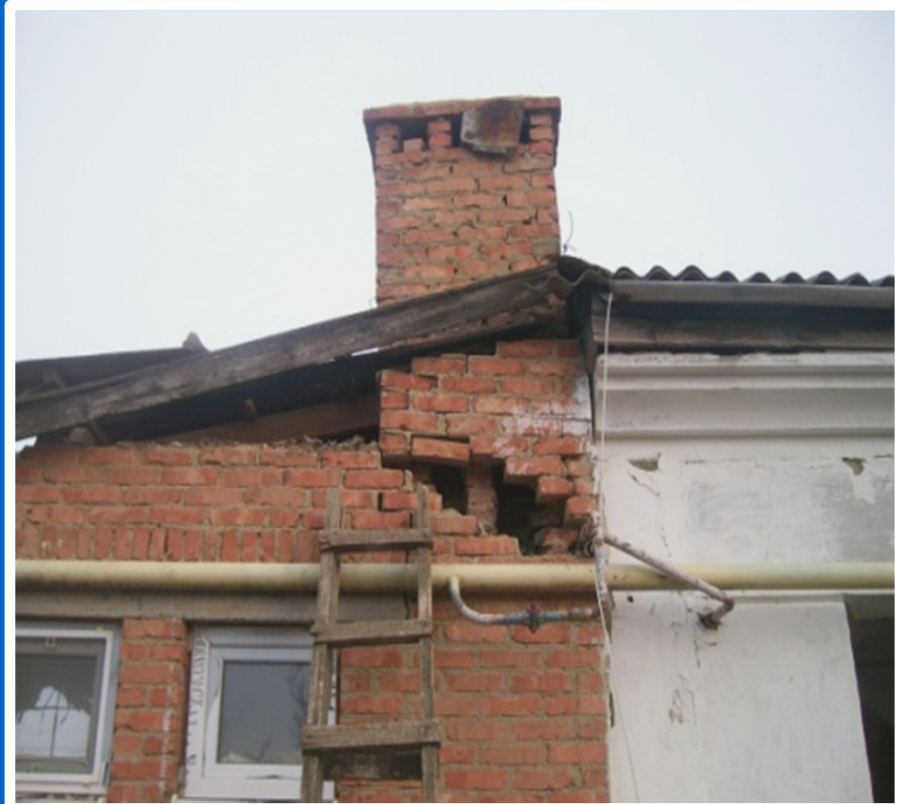
✓неисправность (разрушение) дымохода и вент. канала
