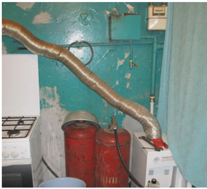
✓нарушение правил монтажа дымохода
